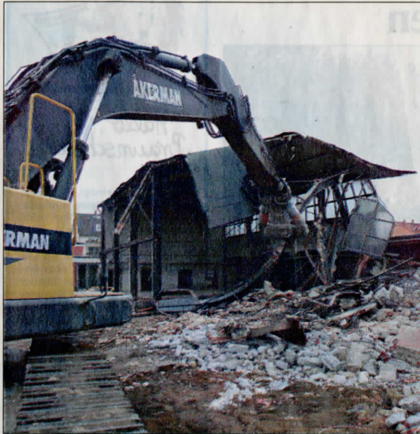
Abbrucharbeiten auf dem ehemaligen Kasernengelände an der Husarenstraße. Hier entstehen 220 bis 230 Wohnungen. Foto: Rudolf Flentje
